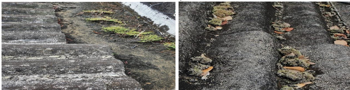
Figura 7 – Registro das diversas deposições e em vários graus sobre as SCE da área edificada do CECA/UFAL.
